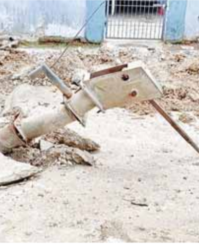
पालिका इसकी सुध लेती है। जनता का कहना है कि पक्की नाली और हैंडपंप को तोड़ने के बाद उसकी भराई कौन करेगा, यह स्पष्ट नहीं है। लोगों का आक्रोश बढ़ता जा रहा है और वार्डवासियों ने चेतावनी दी है कि यदि क्षतिग्रस्त निर्माण की मरम्मत और पेयजल सुविधा जल्द बहाल नहीं की गई, तो वे आंदोलन के लिए बाध्य होंगे।
